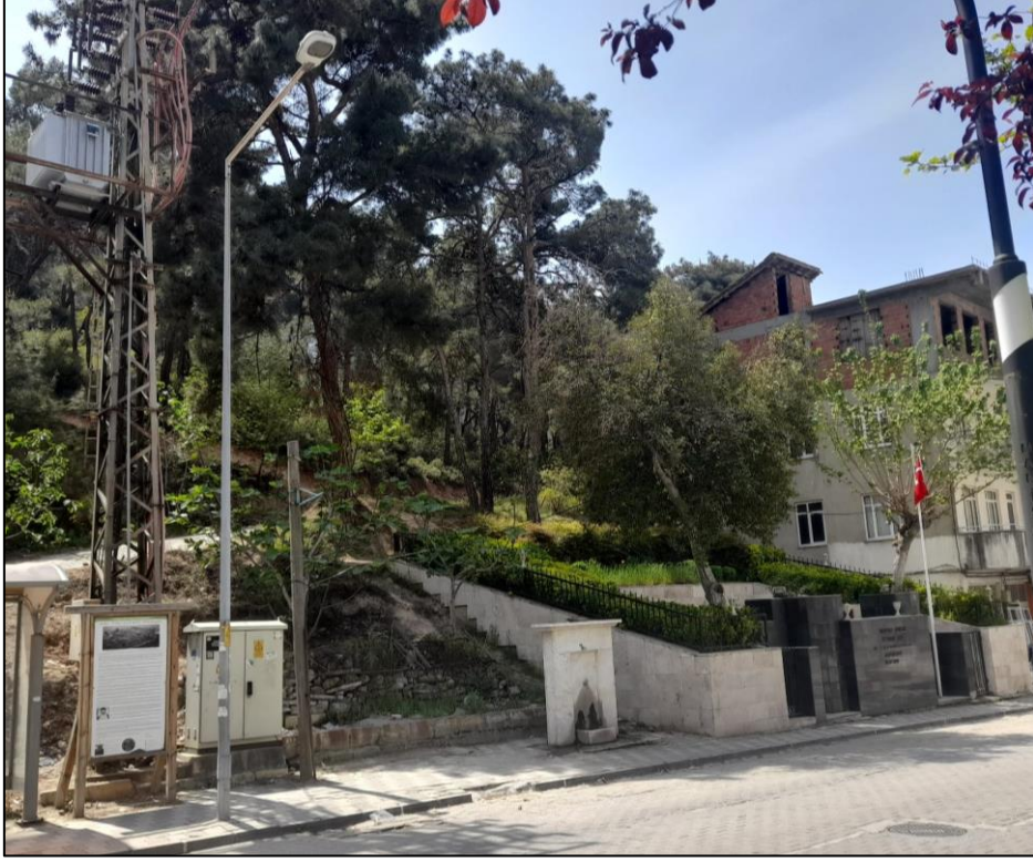
- Öneri Trafo Alanından Görüntü-
